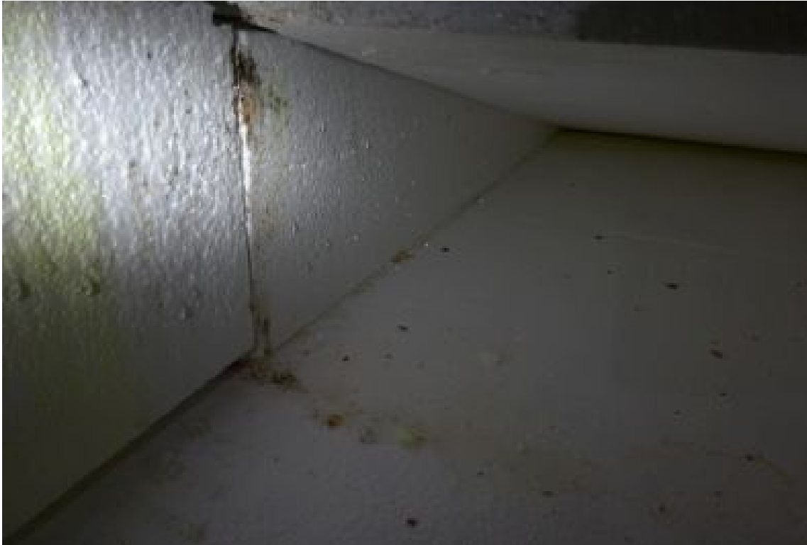
Abb. 1.3: Kondensat an EPS-Stößen
